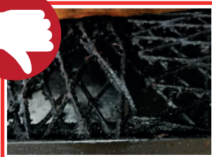
Photo 26 : grillage en mauvais état d'entretien
